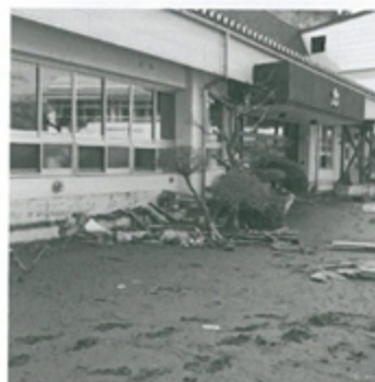
床上浸水した小本小学校の校舎
